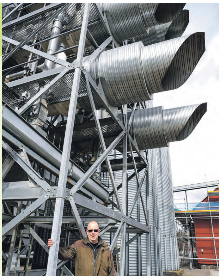
Anders Malmström, inspektor på Trolleånäs gods vid gårdens tork.
